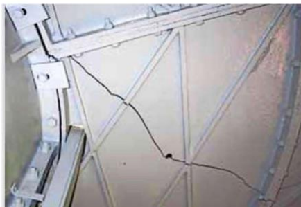
Een grote scheur in een gietijzeren vloer van een van de 17 verdiepingen. FOTO VWN
